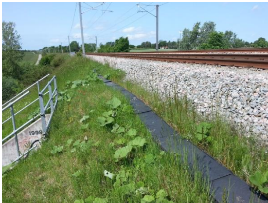
Figur 4.18. Kabelkasser langs banen.
